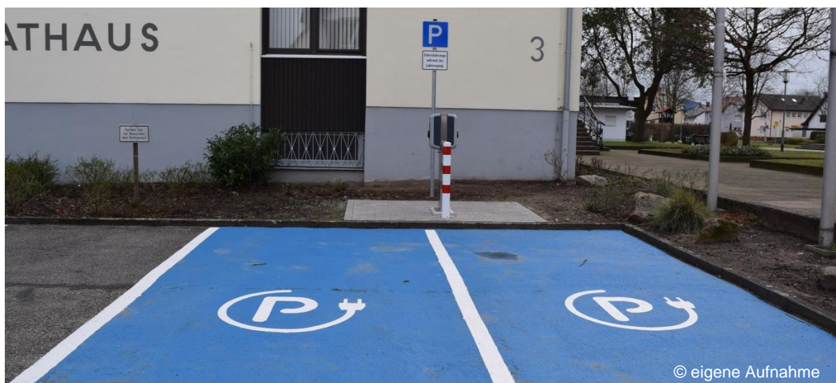
Abbildung 3-21: Ladesäule am Rathaus in Ötigheim
